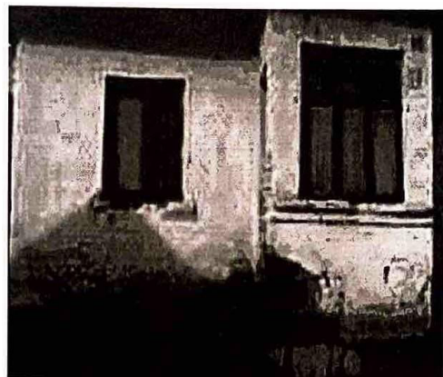
Fig. 16 Perete din chirpici, fisurat
