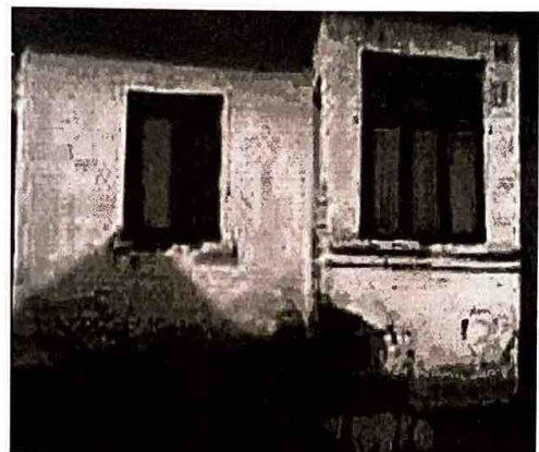
Fig. 16 Perete din chirpici, fisurat
