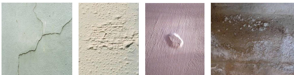
Fig. 42. Defecte ale suprafețelor tencuite
