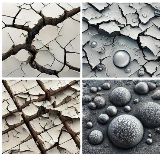
Fig. 33. Defecte ale hidroizolației
