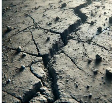
Fig. 25. Fisuri și crăpături
