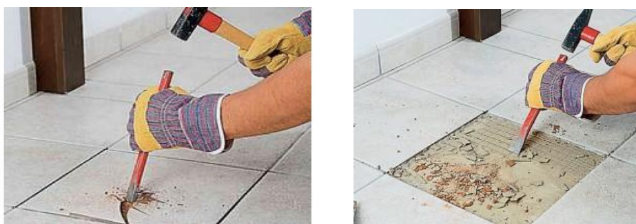
Fig. 65. Remedierea defectelor pardoselii
